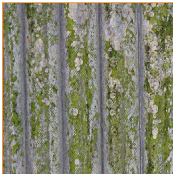
Plaques fibres-ciment dégradées
