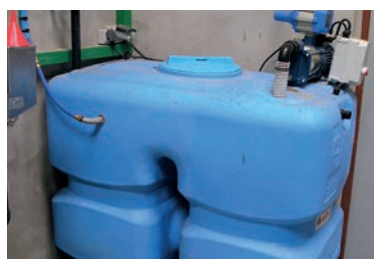
Cuve de stockage d'eau
