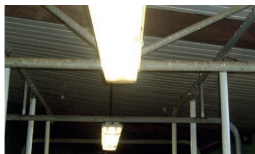
Doubles néons sous tubulures
