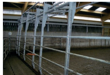
Barrières poussantes dans le parc d'attente
