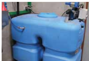
Cuve de stockage d'eau
