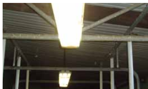
Doubles néons sous tubulures
