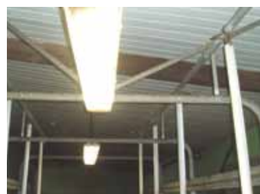
Doubles néons sous tubulaires
